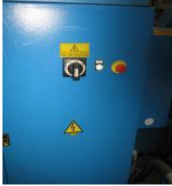
E1 ELEKTRİK ENERJİSİ ELK. PANOSUNDAKİ ŞALTER
