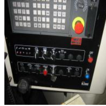
E4 ELEK. ENERJİSİ OPR. PANELİNDE BULUNAN ANAHTAR
